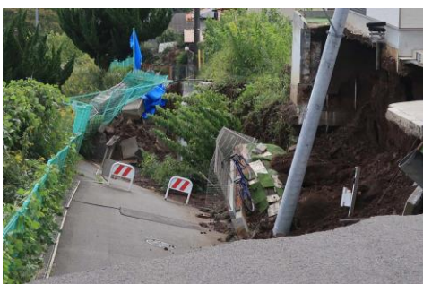
まさに想定外、台風の大雨による突然の 道路陥没(平成29年)。
